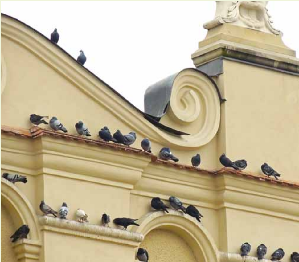
Ryc. 45. Gołębie miejskie przyczyniają się do niszczenia elewacji budynków (fot. A. Zbyryt)
