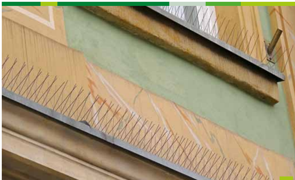
Ryc. 47. Kolce na fasadach zagrażają życiu i zdrowiu ptaków dlatego warto stosować inne rozwiązania np. spirale druciane lub ruchome pręty (fot. A. Zbyryt)
